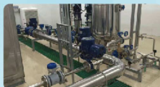
自来水管、闸门、泵站、水厂监控
