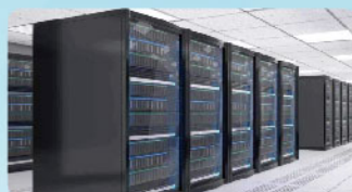
无人值守机房监控和远程维护
