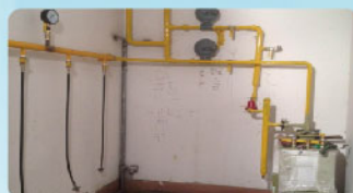
煤气管道、闸门、加压站监控
